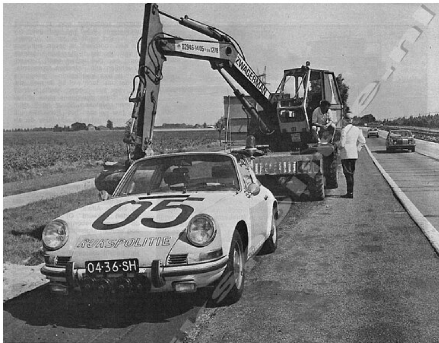
Een kraanbestuurder die met zijn apparaat gevaarlijk over de weg zwaaid wordt tot de orde geroepen.
